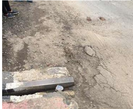
Gambar 4. Kerusakan berupa bleeding dan retak halus/rambut
